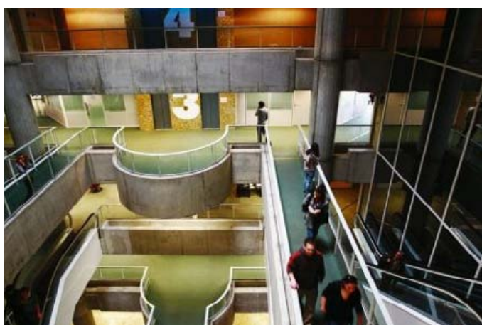
Le changement des escalators et la reconfiguration des niveaux, au programme du nouveau chantier de la bibliothèque. (Thierry David)
